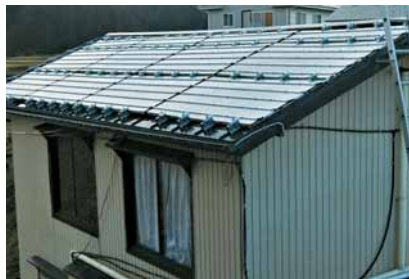
屋根に設置した融雪装置
